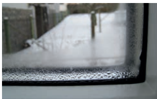
Abb. 3: Durch den Aluminium-Abstandhalter im Isolierglas kann am Rand der Glasscheibe leicht Tauwasser entstehen
